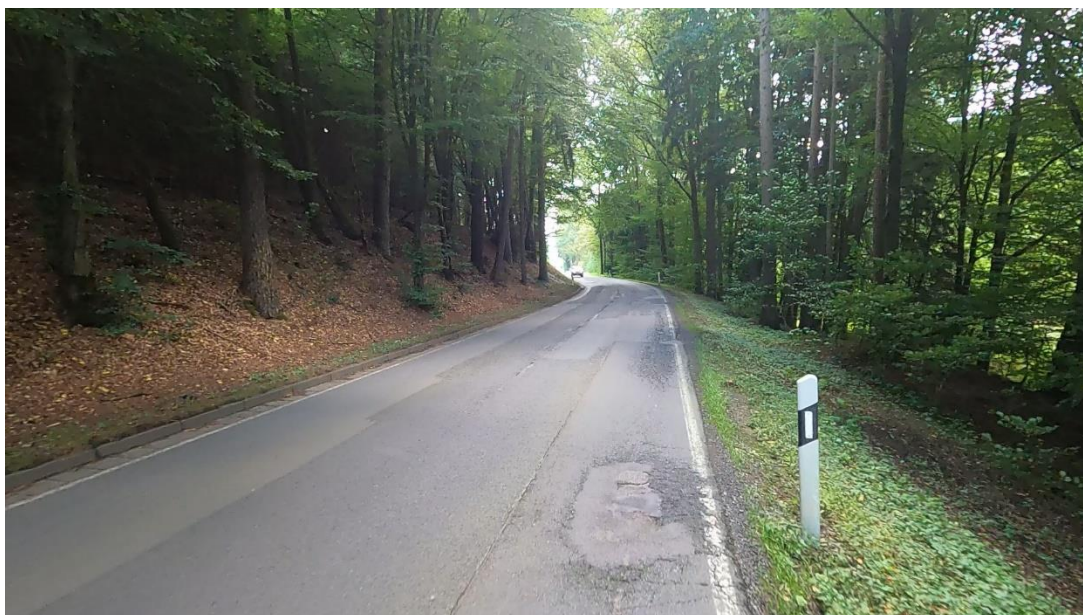
Abbildung 24: Schäden vor allem im Randbereich der Fahrbahn [Foto: R+T]
